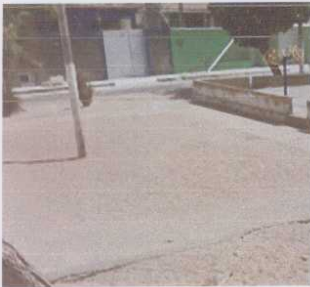
Foto 1 – Execução de piso cimentício, remoção de poste para lateral e Instalação de um ponto de energia;
