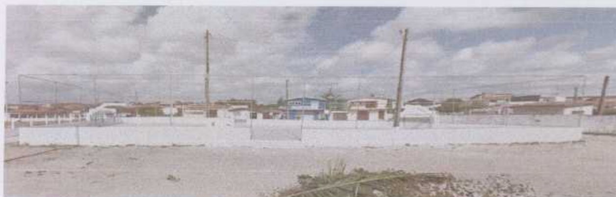
Foto 1 - Reconstrução de telas de proteção juntamente com a estrutura em aço galvanizado;
