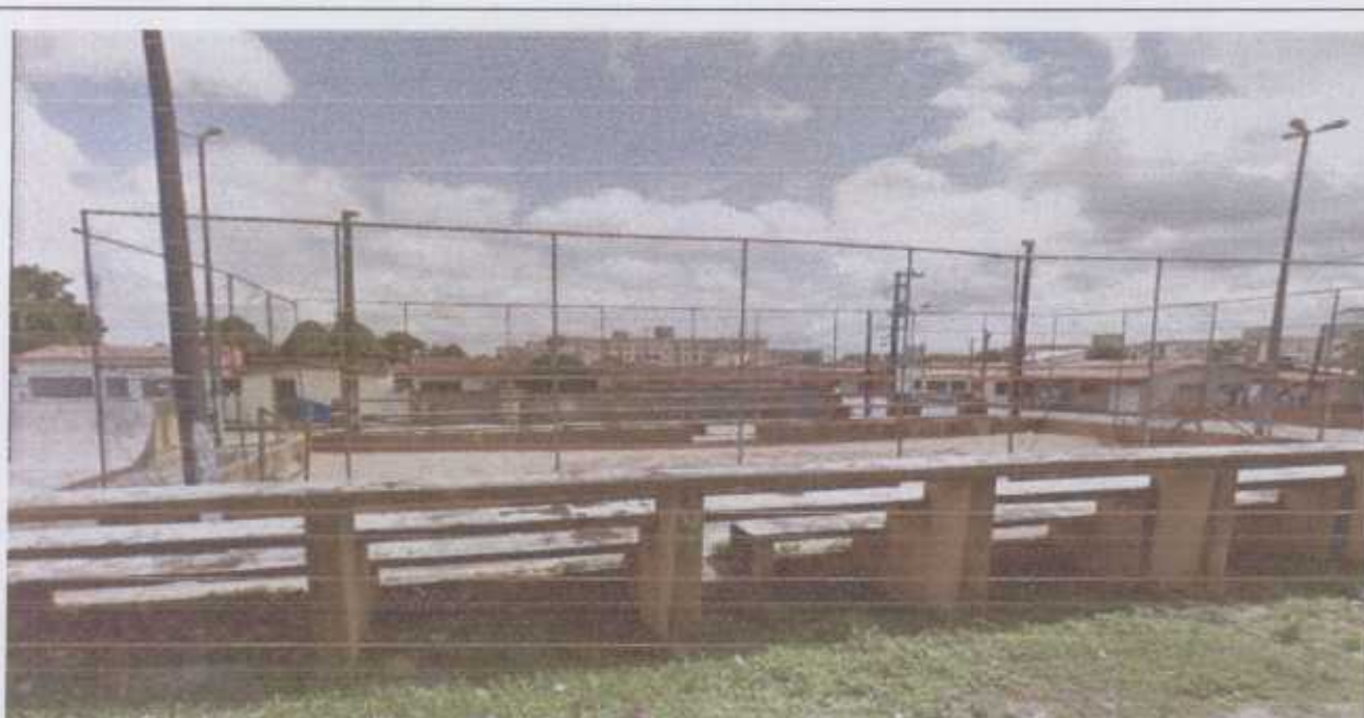
Foto 1 - Reconstrução de telas de proteção juntamente com a estrutura em aço galvanizado;
