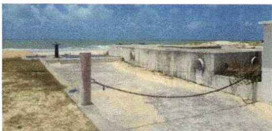
Figura 12. Estação elevatória de esgoto da CAERN. Fonte: Glênio Lima, 2017.
