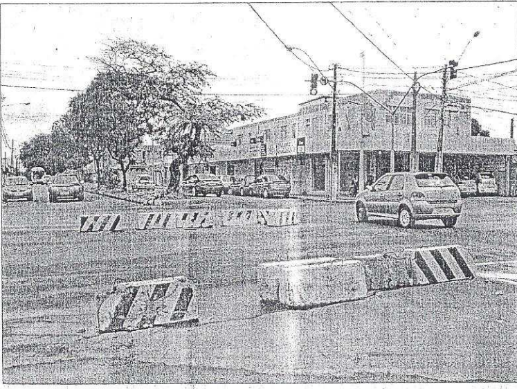
Na Jerônimo Câmara, a pavimentação está concluída, mas ainda falta terminar as obras das calçadas
